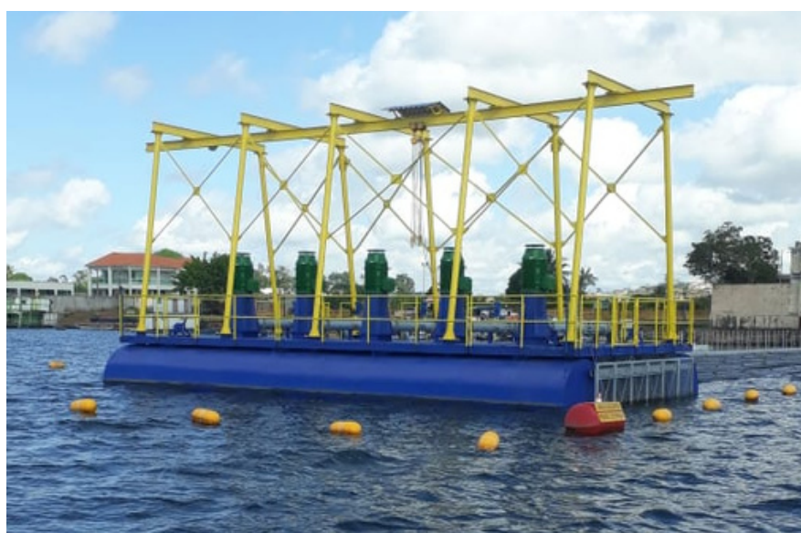
Captação Flutuante fabricada em aço carbono, Rio Xingu, Altamira, Pará | 2020
