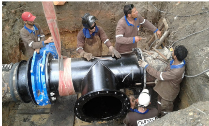
Interligação Alimentação do Poço de Sucção
