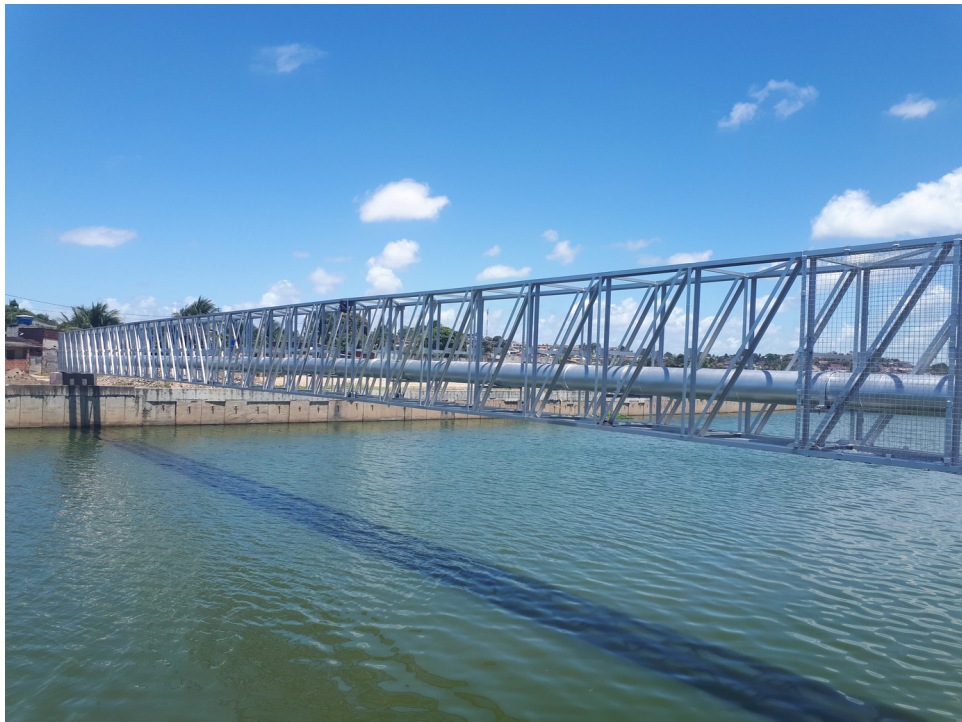
Travessias Aéreas DN 250 e DN 400mm, provida de Estrutura Treliçada sobre Canal, vão 50 metros, Olinda/PE
